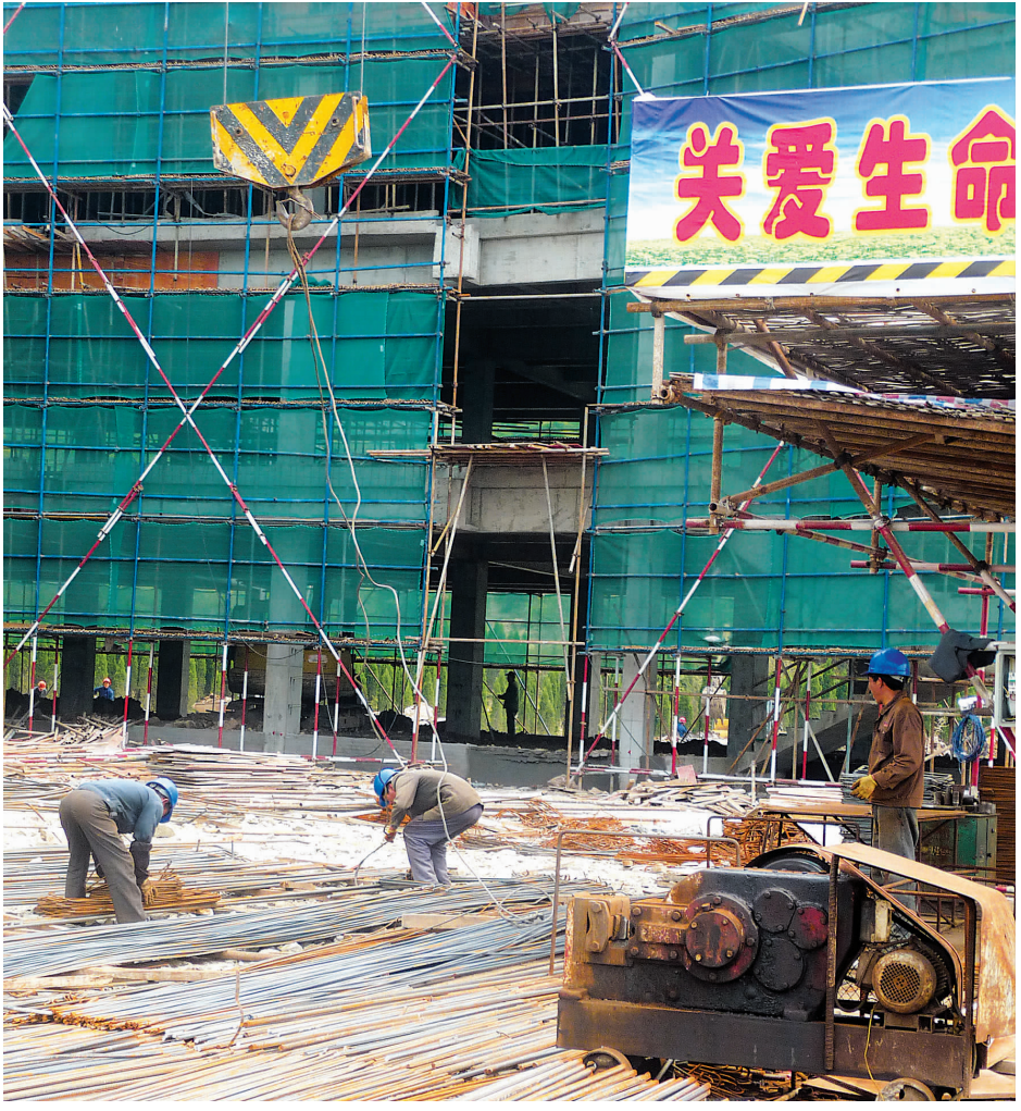
昨日下午,市青少年活动中心一期工程施工工地上,工人们正在紧张施工。据了解,市青少年活动中心一期工程计划在年内竣工,预计在明年上半年向全市青少年开放。
