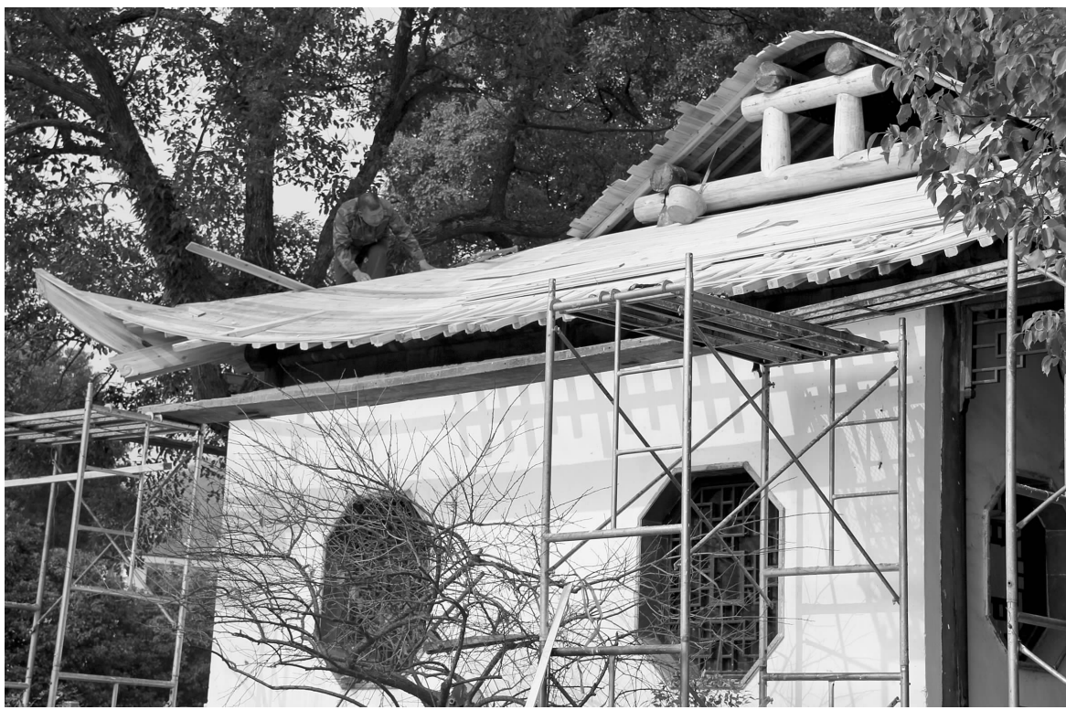
东湖景区一处建筑遭到白蚁啃噬，屋顶局部出现塌陷，存在安全隐患，目前相关部门已对该建筑周边部分路段实施封道，着手维修塌陷的屋顶，预计元旦前完工。
